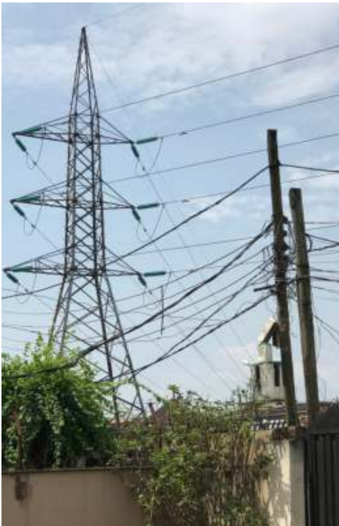
Distribution de l'électricité au Nigeria
